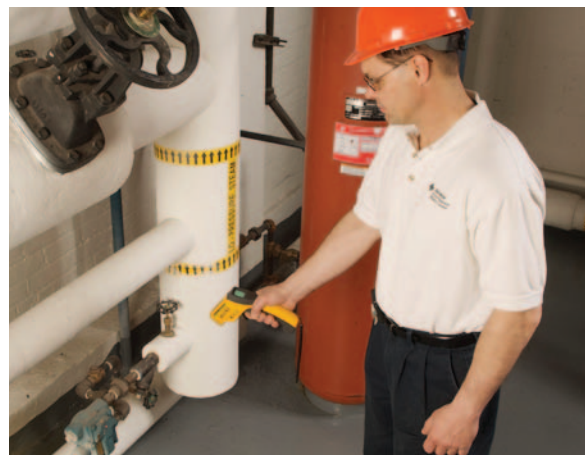
HVAC/电厂经理 Darryl Dylla 使用 Fluke 62 红外线测温仪检查 HVAC 系统的蒸汽疏水阀。
