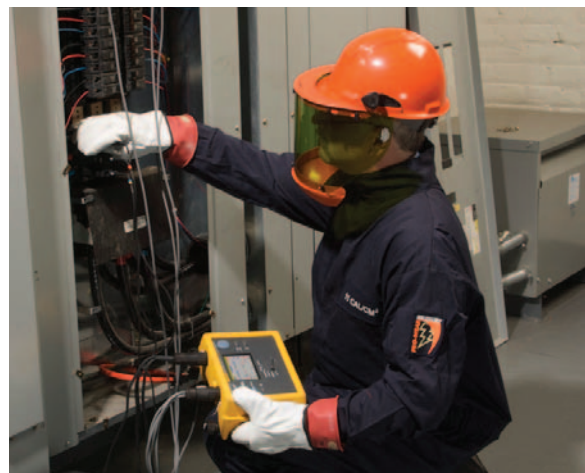
电工 Rolf Zoeller 使用 Fluke 1735 三相电能记录仪研究医院电气系统的负荷。密切关注这些系统帮助医院实现其能源之星评级。
